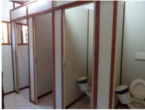
Padrão banheiro alojamento Amarelo
