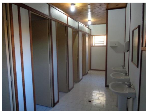
Padrão banheiro alojamento Amarelo
