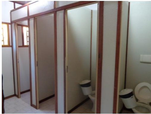
Padrão banheiro alojamento Amarelo
